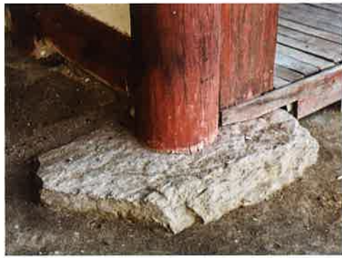
동금강암 앞면 서쪽 귀기둥 주춧돌 東金剛庵 前面 西側 隅柱 礎石 plinth for front western corner column, Tonggümgangam
