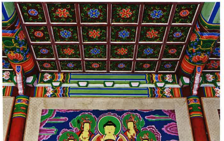
대웅전 내부 뒷면 액방과 도리 / 大雄殿 內部 後面 額枋·道里 backward lintel and cross-beam, Taegungjon hall
