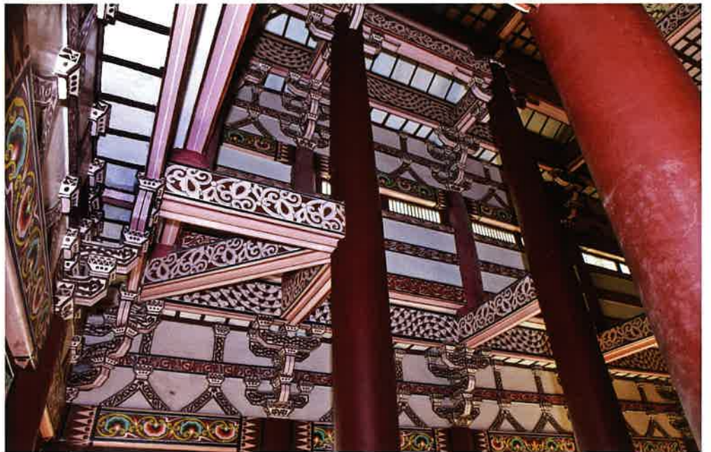
보광전 내부 뒷면과 고주 / 普光殿 內部 後面·高柱 / backward side and highly pole supporter, Pogwangjŏn hall
