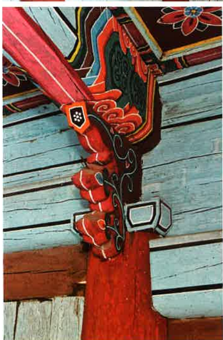
대웅전 내부 동쪽 공포 / 大雄殿 內部 東側 栱包 eastern brackets, Taeungjŏn hall
