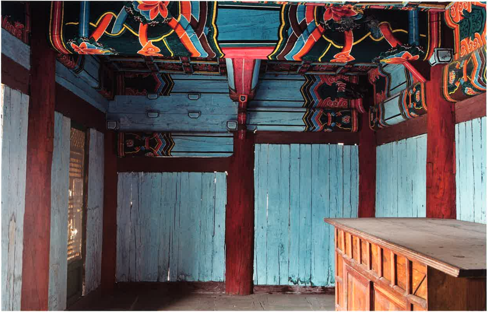
대웅전 내부 서쪽 벽체 / 大雄殿 內部 西側 壁體 / western wall, Taeungjŏn hall
