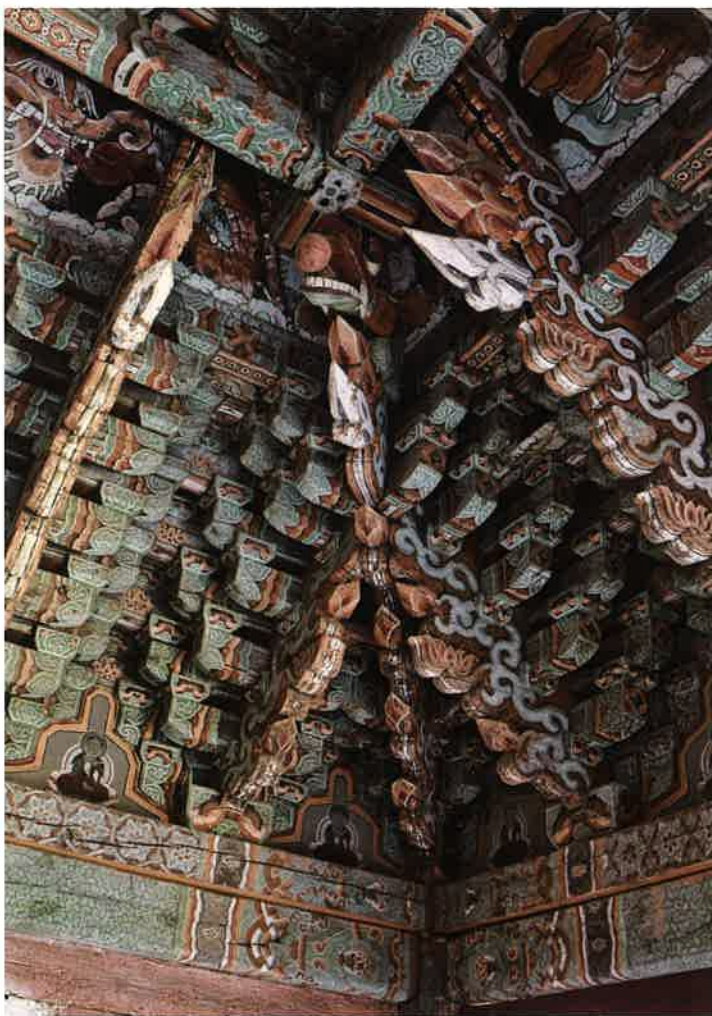
보광전 내부 앞면 동쪽 귀포 / 普光殿 內部 前面 東側 耳包 front eastern corner brackets, Pogwangjŏn hall
