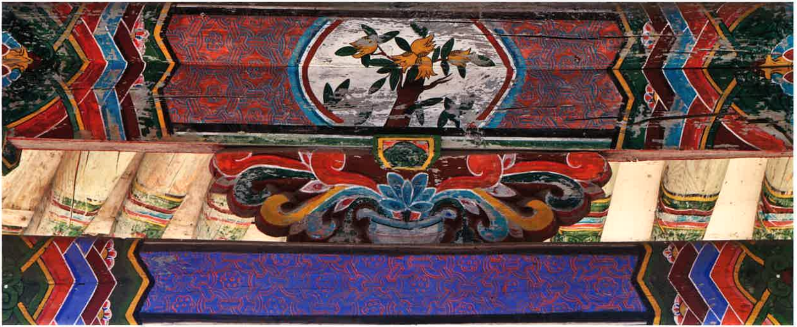
천주루 내부 앞면 화반 / 天柱樓 內部 前面 花盤 / front Hwaban, Ch'önjuru hall
